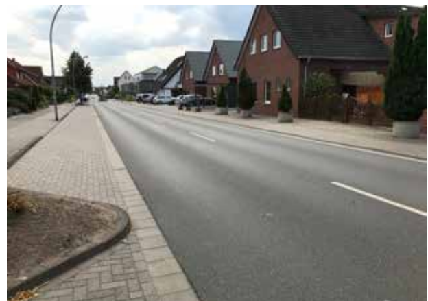
Bild 6: Zustand der Fahrbahn 2020
