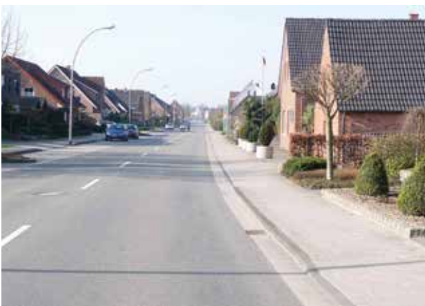
Bild 5: Zustand der Fahrbahn 2009
