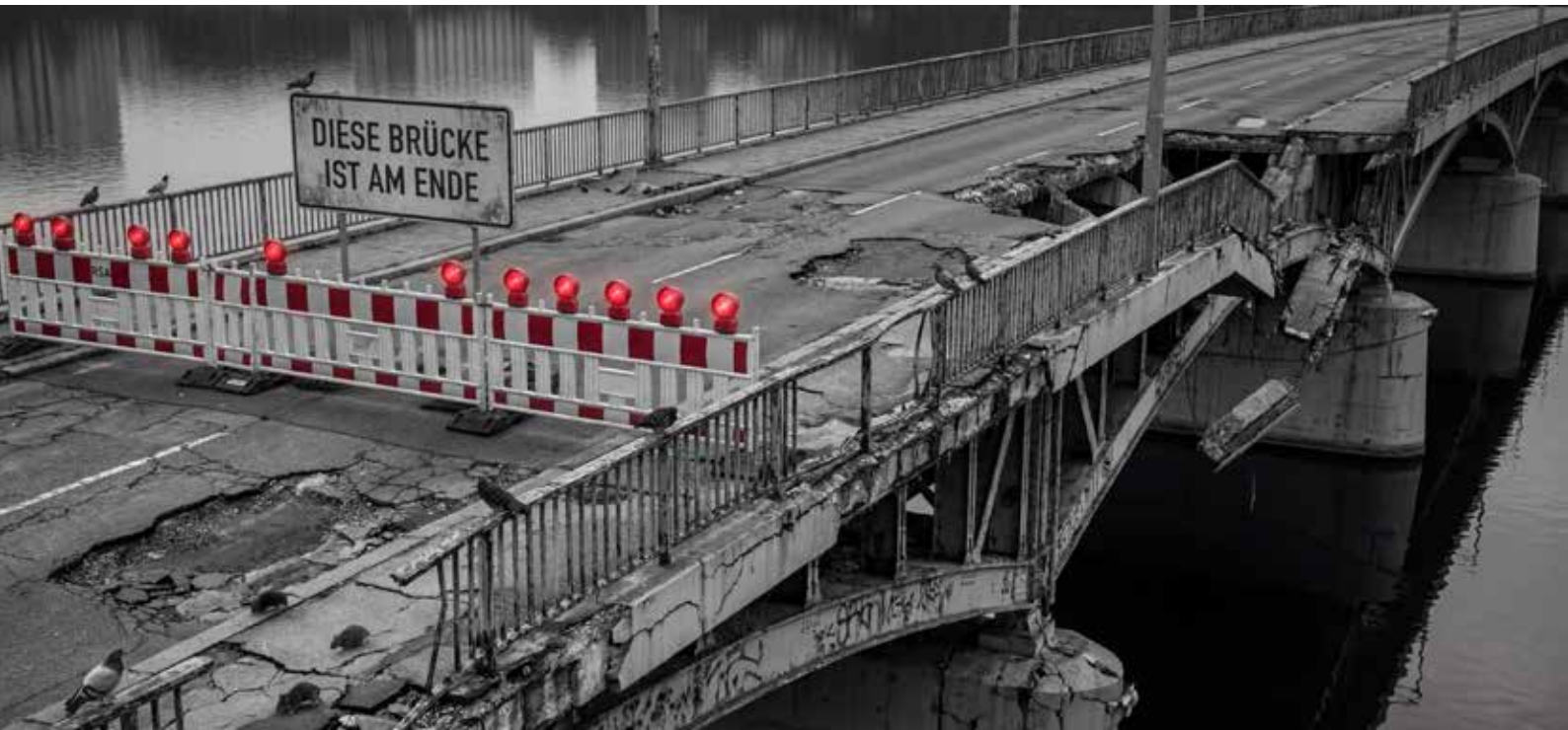
Abb. 1: stark beschädigte Brücke – Foto: Pollo.ai (KI-generiert)
