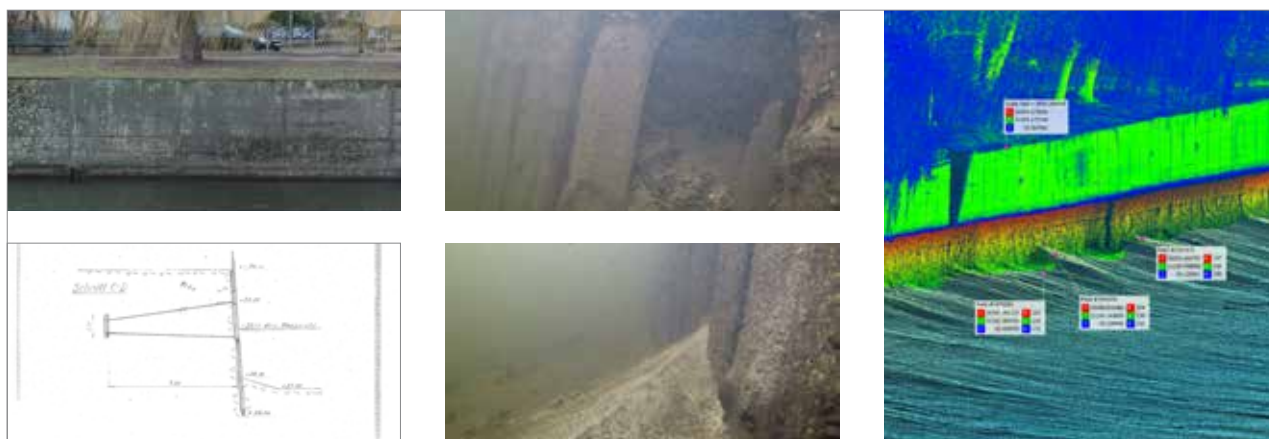
Abb. 8: Schleswiger Ufer (SOW linkes Ufer km 11,2) – Trägerbohlwand (vor 1914 / einsturzgefährdet vor der Sicherung) – Ansicht / Bestandsplan / aufgelöste Holzkonstruktion mit Materialverlust / Scans
